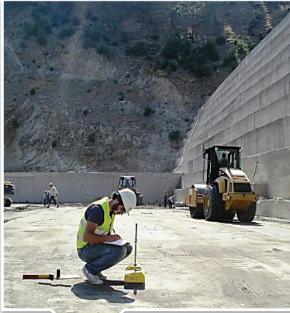
Yerinde Sıkışma Kontrolü -Nükleer Yoğunluk ve Nem Ölçer
